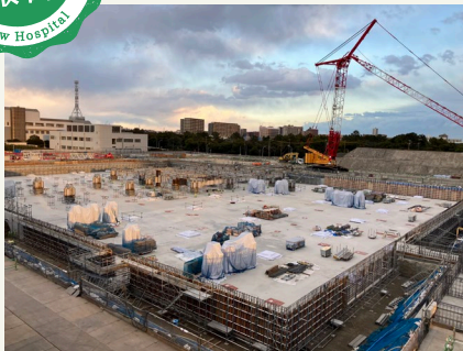
2024年12月25日 病院本体棟にて免震装置の設置が完了しました。
